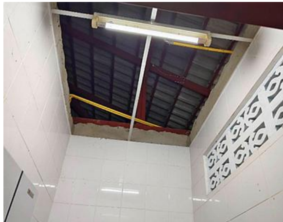
解決廁所漏水問題
